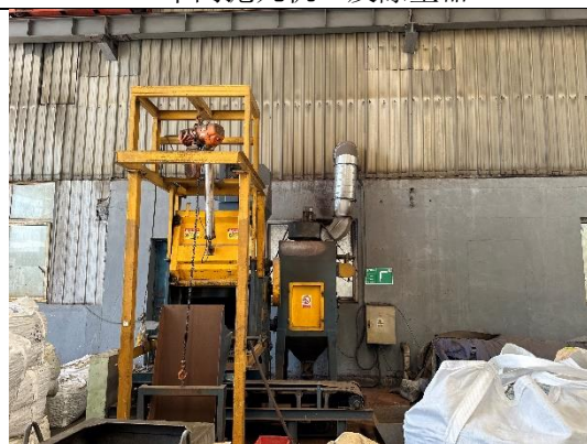
一车间抛丸机 3 及除尘器
