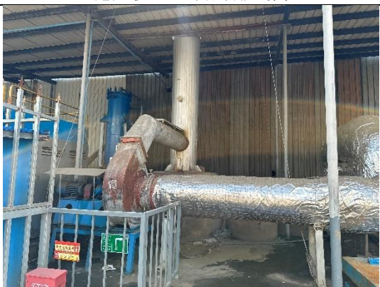
一车间天然气燃烧尾气
